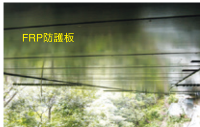
FRP防護板 沖縄科学技術大学院大学2号橋 ((独) 沖縄科学技術研究基盤整備機構 平成22年度竣工)
