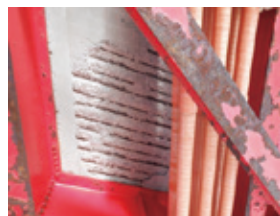
床版下面の海水による塩害損傷
