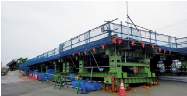
写真-7 軌条受けベント設備
