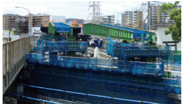
写真-9 橋台上設備
