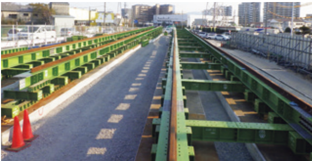
写真-6 軌条設備
