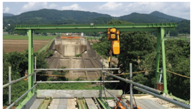
写真-13 テルハクレーン
