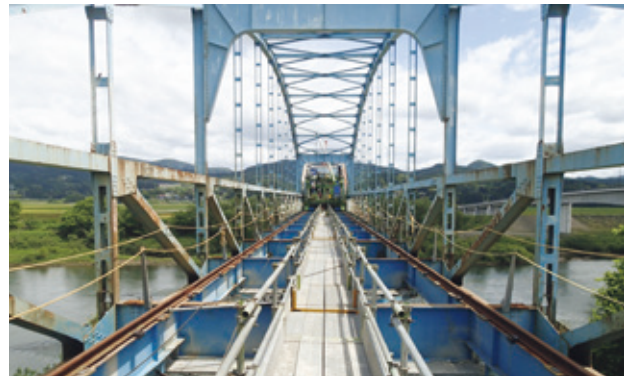
写真-11 軌条設備
