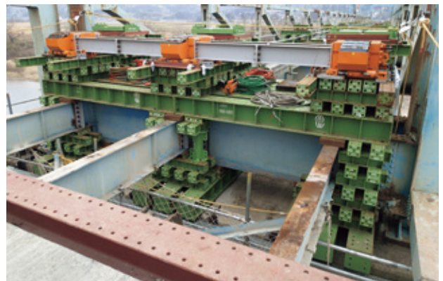
写真-5 引き戻し設備
