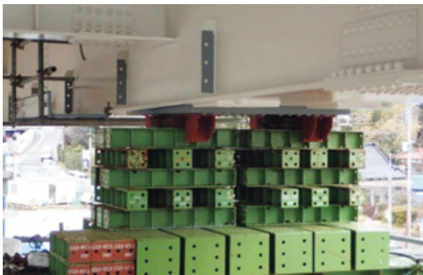
写真-6 架設桁の滑動防止設備
