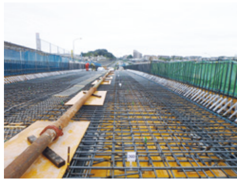
写真-11 河川上配管状況
