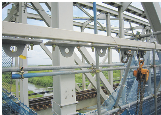
写真-16 ハンガーレール設備
