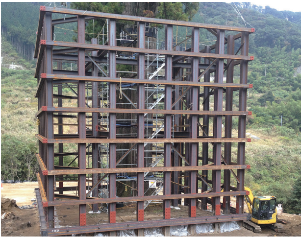
写真-3 鋼製保護枠
