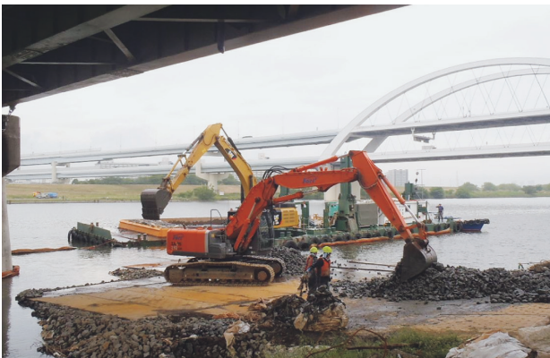
写真一八 バックホウ台船・バックホウによる撤出状況
