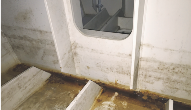
写真-12 脚内の滞水状況
