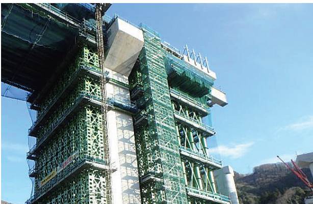
写真-11 橋軸方向ストッパー設備
