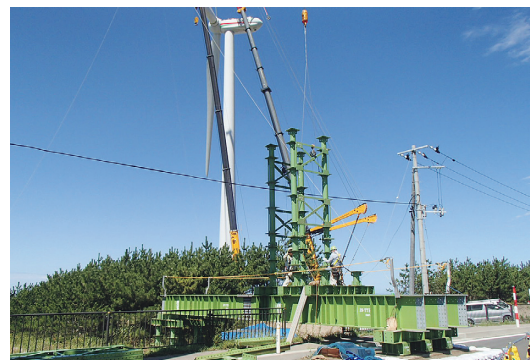
写真一7 ベント設備
