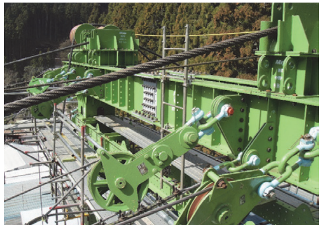
写真-2 A1鉄塔設備（上部）
