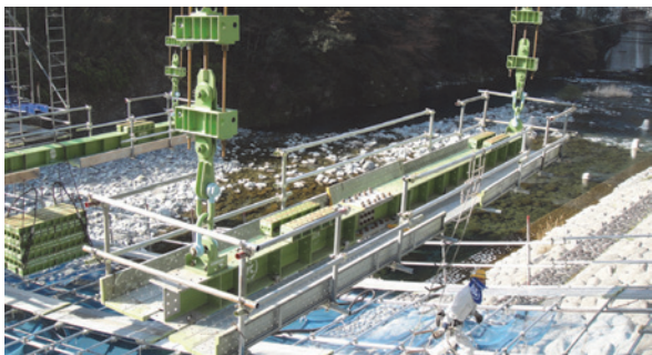
写真-4 吊り索設備
