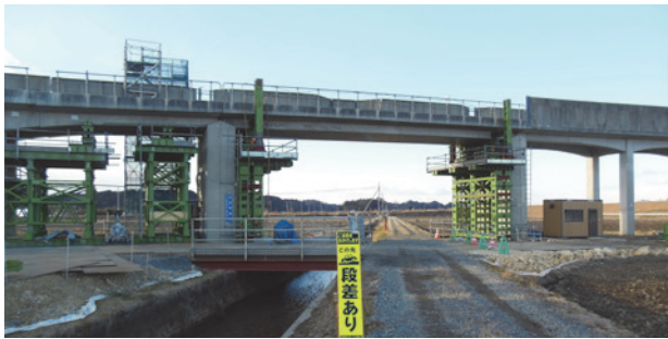
写真-12 Csdp-2ベント設備
