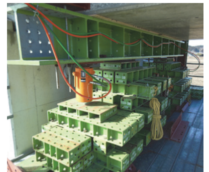
写真-14 Csdp-2ジャッキアップ設備
