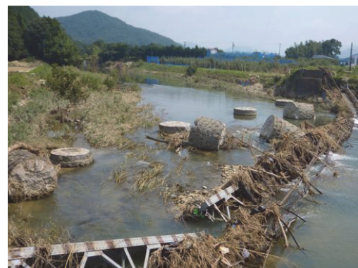
写真-1 第6阿武川橋りょう流出状況
