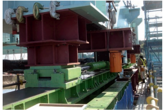
写真-4 横取り設備
