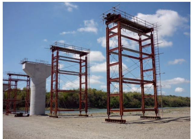
写真-2 ベント設備 (フィリピン国内リース品)
