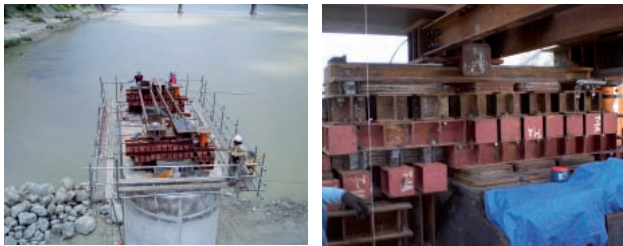
写真一三 送出し設備
