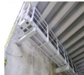
熊本橋下部工検査路 (FRPブラケット仕様) (NEXCO中日本 平成23年度竣工)
