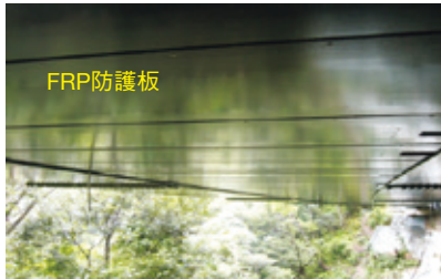
FRP防護板 沖縄科学技術大学院大学2号橋 ((独)沖縄科学技術研究基盤整備機構 平成22年度竣工)
