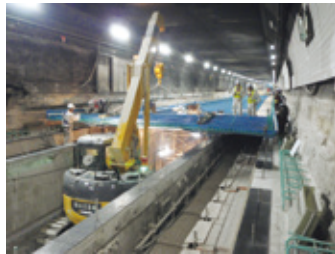
関門トンネル (床版打替え工事) (NEXCO西日本 平成22年度竣工)
