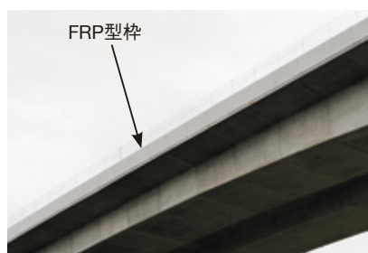
高倉川橋（PC上部工の埋設型枠への適用） (NEXCO東日本 令和2年度施工中)
