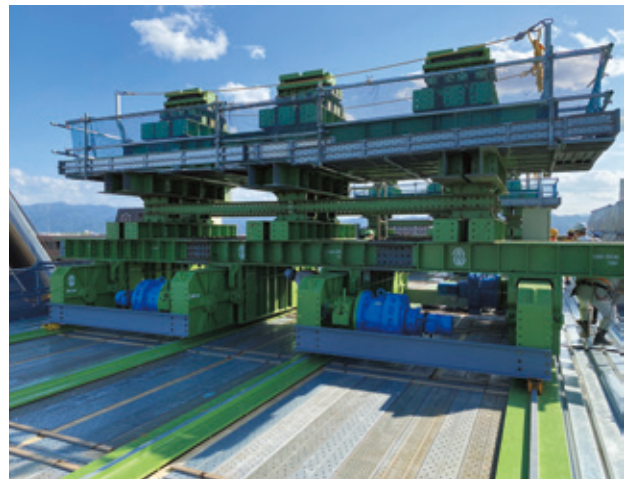
写真-11 台車設備
