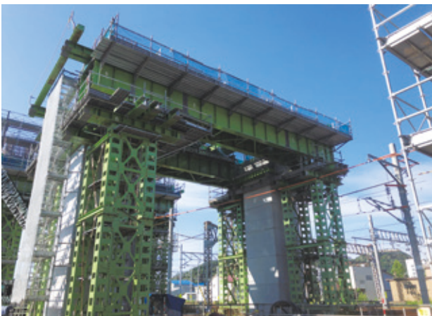
写真-1 桁式支保工設備
