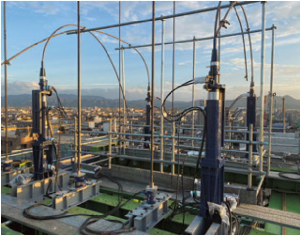
写真-12 降下装置
