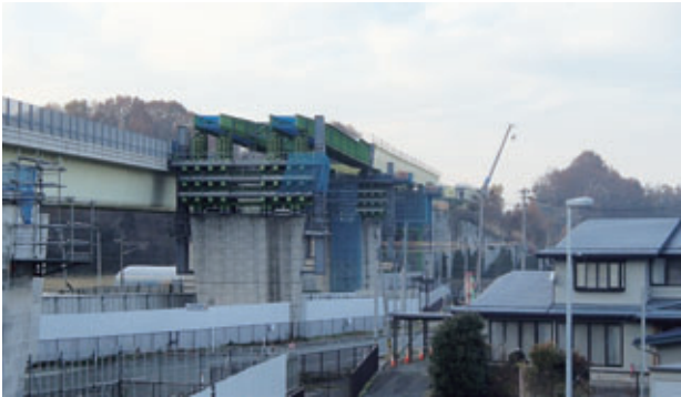
写真-6 耐震設備
