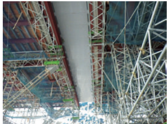
写真-16 渡り設備裏面
