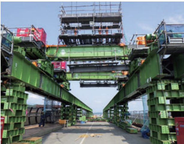
写真-5 吊り上げ台車設備
