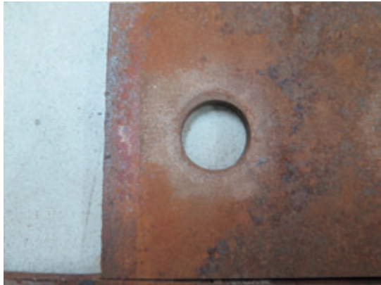
写真一五 摩擦接合面の腐食状態
