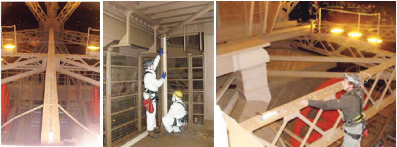
図-13 エッフェル塔へのLIRIS設置状況（OSMOS社提供資料より）
