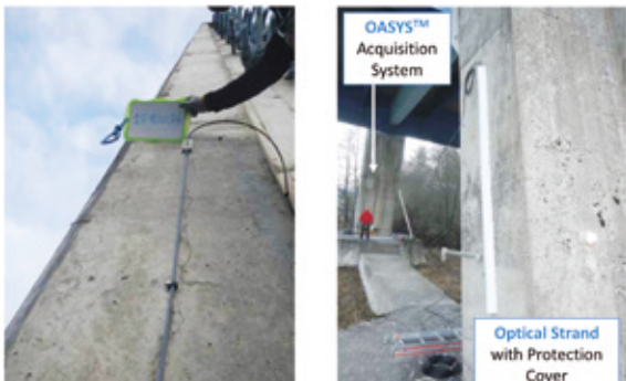
図-16 センサー設置状況（OSMOS社提供資料より）
