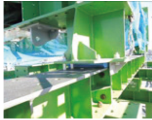
写真-13 滑り支承
