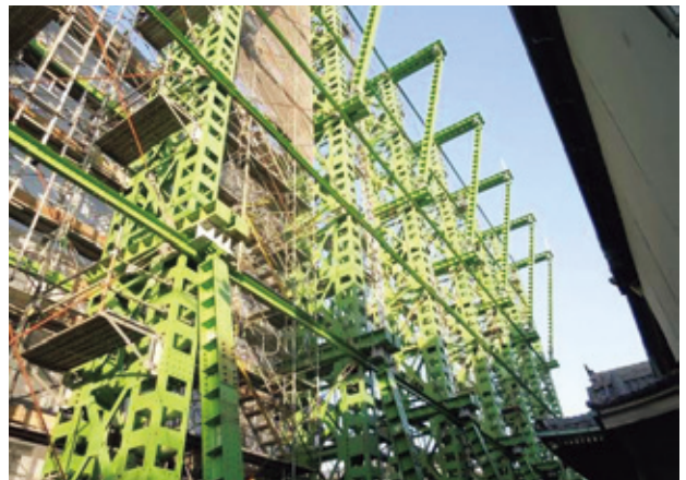
写真-5 □500ベント (B5ベント)
