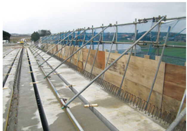
写真-7 桁上控えパイプ
