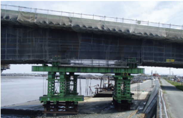
写真-3 堤外地ベント設備
