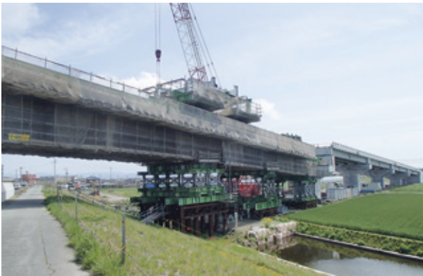
写真-2 堤内地ベント設備
