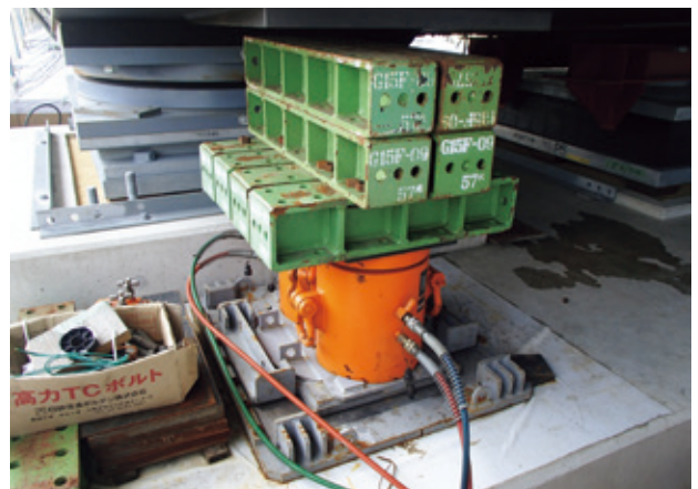
写真-9 P5支点縦送り装置
