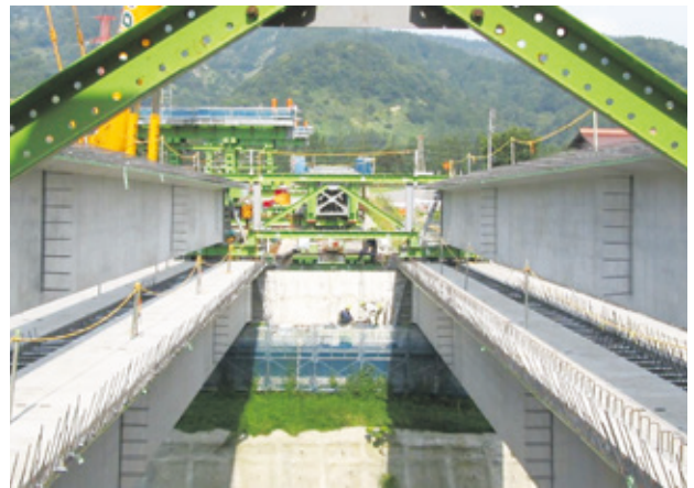
写真-8 耐震設備（G3、G4間）
