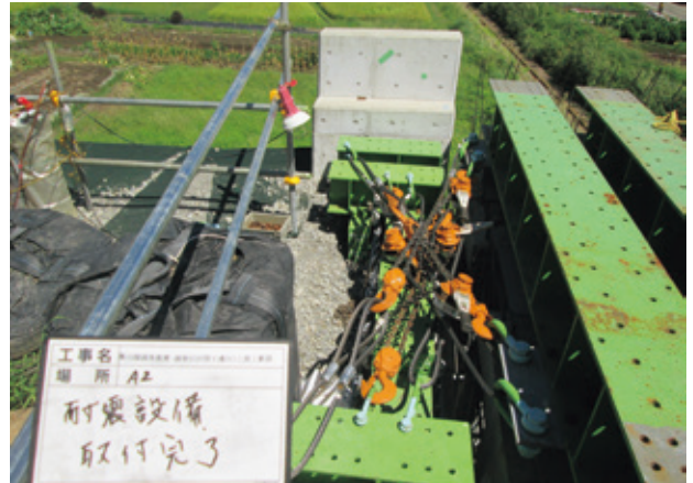
写真-7 耐震設備（パラペット部）
