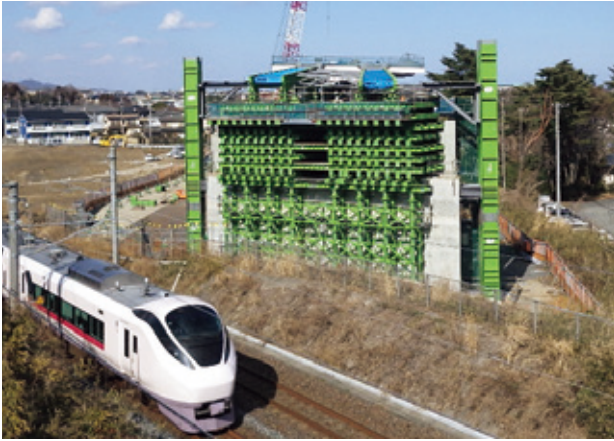
写真-12 A2側耐震設備
