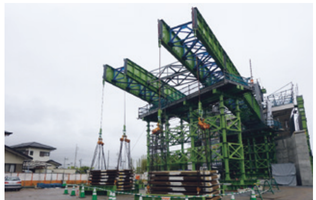
写真一一 A1側カウンター設備
