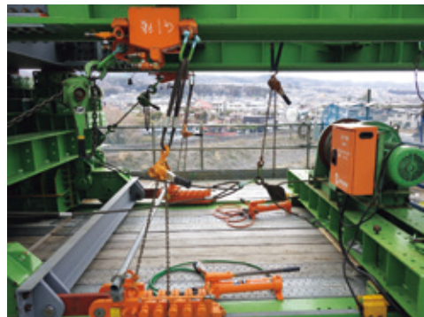
写真-6 おしめ設備
