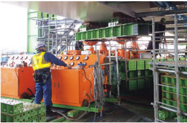
写真一七 送り出し設備
