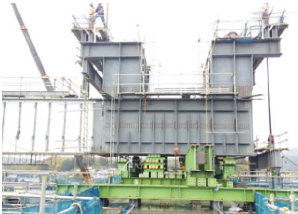
写真-10 桁降下機
