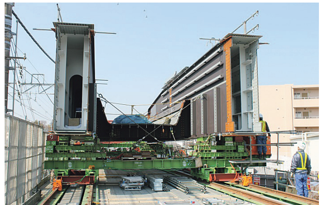
写真-3 台車設備
