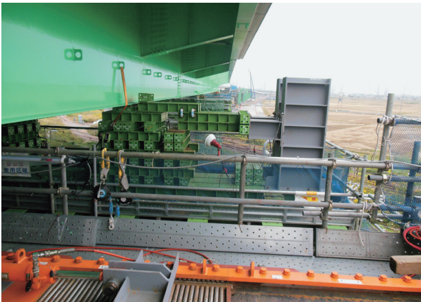
写真-12 耐震設備写真
