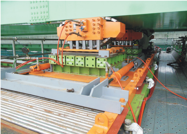
写真-11 ジャスコロ設備写真
