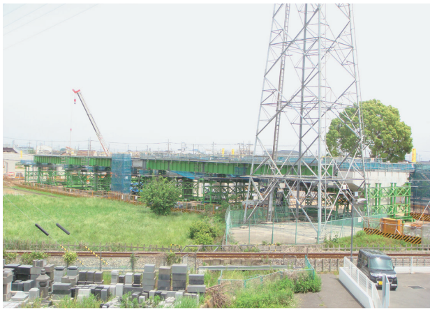
写真-1 軌条設備
