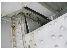
写真-26 ゲルバー部損傷箇所
