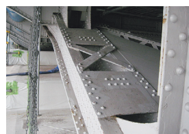
写真-32 下弦材補強前
