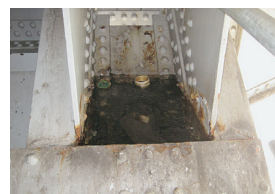
写真-35 水溜まり箇所
