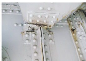
写真-28 あご掛け部補修前
