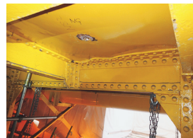
写真-1 損傷状況
