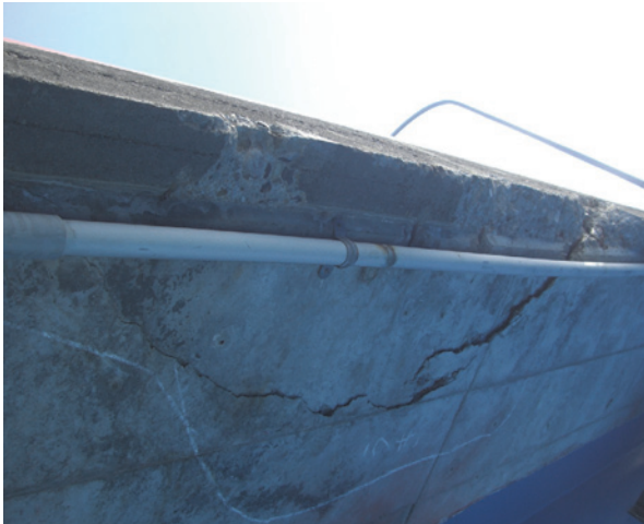
写真一2 床版損傷状況 (床版張出部下面：P4～P5)
