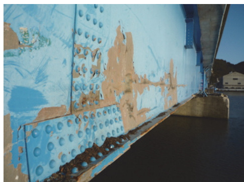
写真-1 主桁損傷状況（主桁ウェブ座屈：P3～P4）
