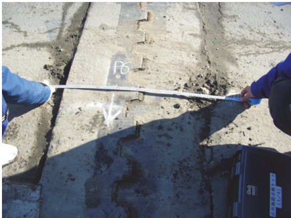
写真一3 桁掛け違い部段差状況 (P6伸縮装置部)
