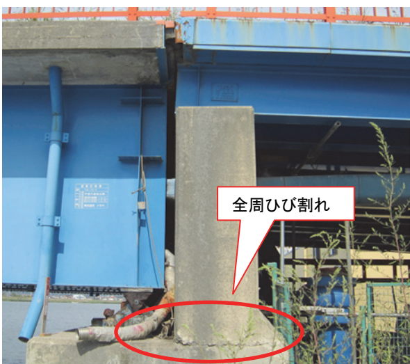
写真一4 P6橋脚パラペット全周ひび割れ状況
