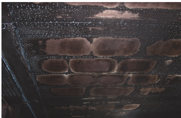
写真-3 合成床版下面の焼損状況
