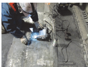
写真-6 き裂先端確認
