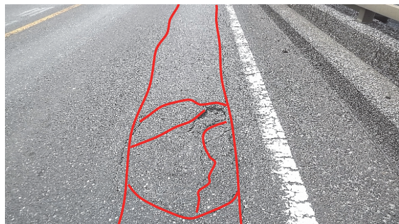
写真-5 舗装のき裂
