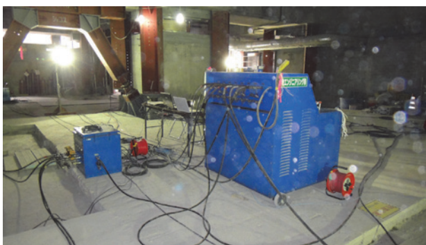
写真-16 油圧ポンプ
