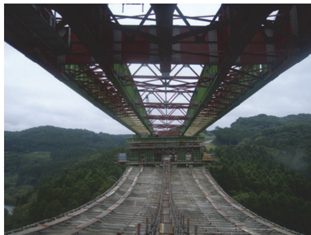
図-10 P3橋脚上設備
