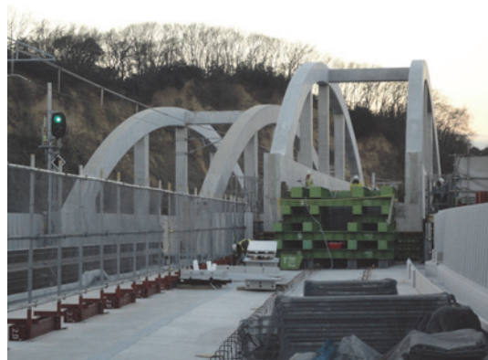
写真-4 耐震設備
