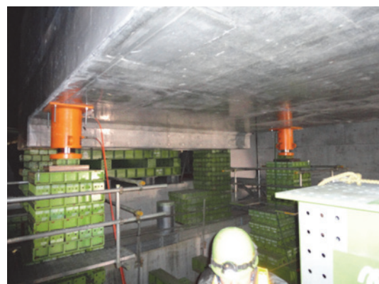
写真-5 降下設備
