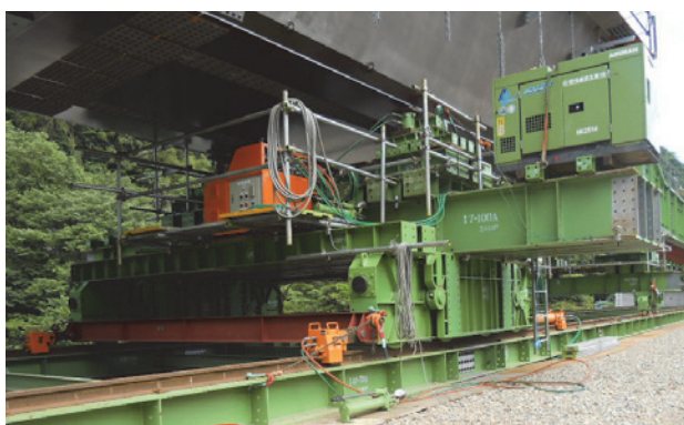
写真-6 推進台車設備
