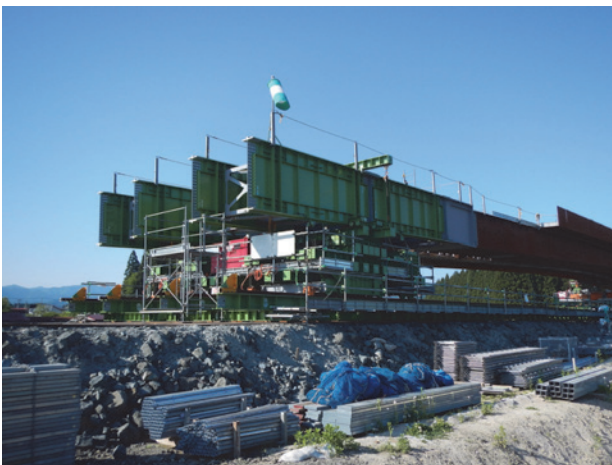
写真-7 従走台車設備
