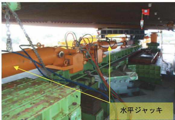
写真-13 P2横取り設備
