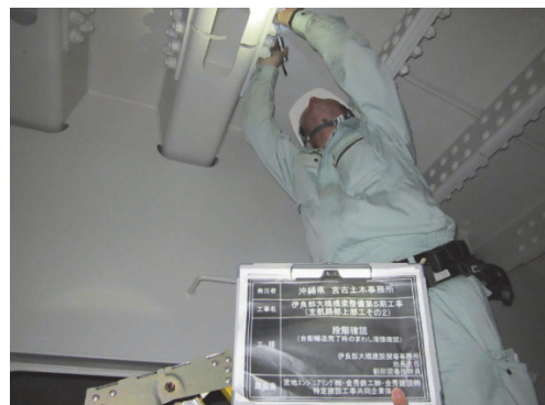
写真一5 塗膜割れの確認状況
