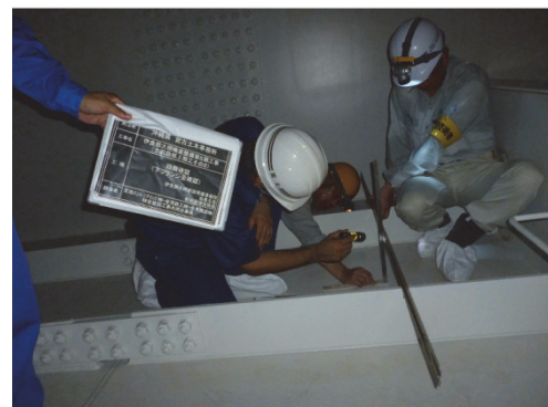
写真一6 残留変位の確認状況
