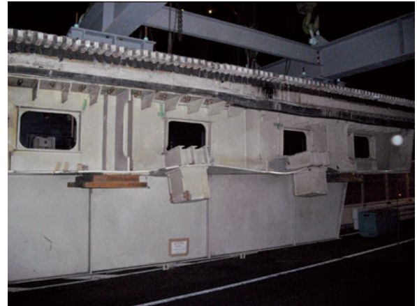
写真一16 撤去桁（拡大）
