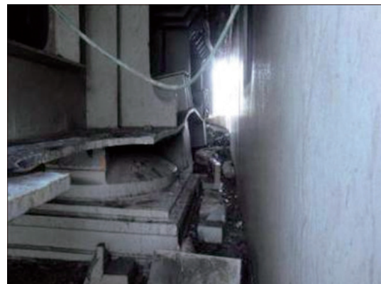
写真-5 大P206橋脚の被災状況（ゲルバー部）
