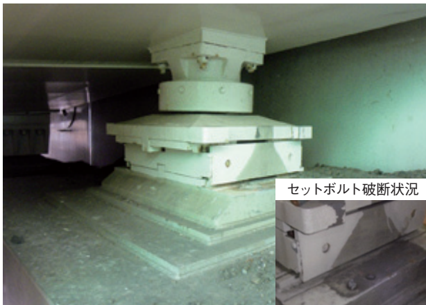
写真-2 横湾P90橋脚の被災状況
