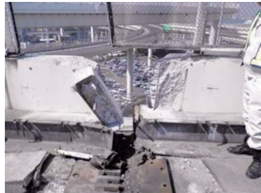
写真-4 大P206橋脚の被災状況（拡大写真）
