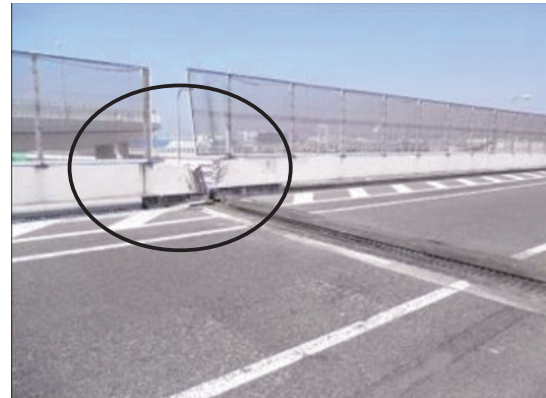
写真-3 大P206橋脚の被災状況（路面の段差）
