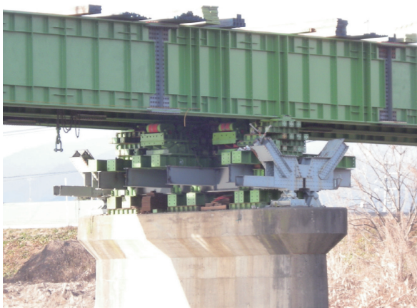
写真-11 橋脚上設備
