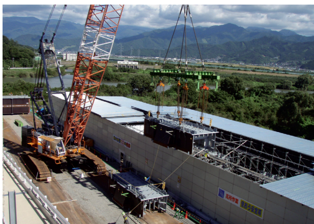
写真-2 大型風防設備
