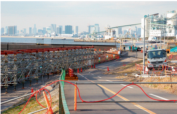
写真-7 ワイヤー防護設備
