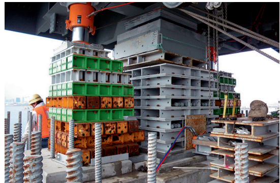
写真-3 高さ調整設備
