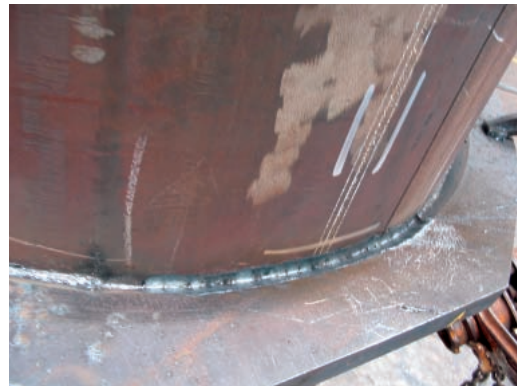
写真-9 ガウジング状況
