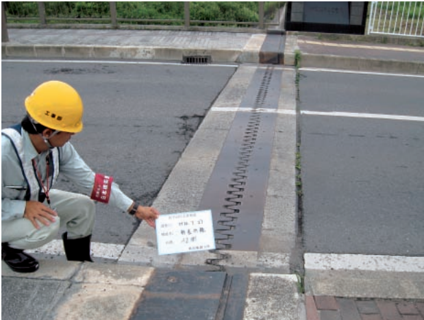
写真一 伸縮装置の例
