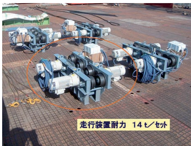
写真-9 移動防護工走行装置
